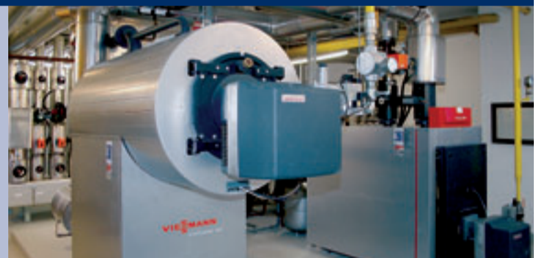
Barghorn Technik Service tauschte die alten Kessel der Schule am Luisenhof gegen einen Brennwertkessel 508 KW und einen Niedertemperaturkessel 285 KW aus.
